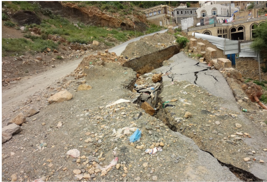
صور توضح بعض الأضرار في الطرق الرئيسية بمدينة حجة
